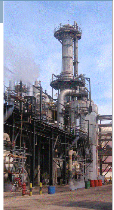
LNG Train, Bethioua, Algeria
